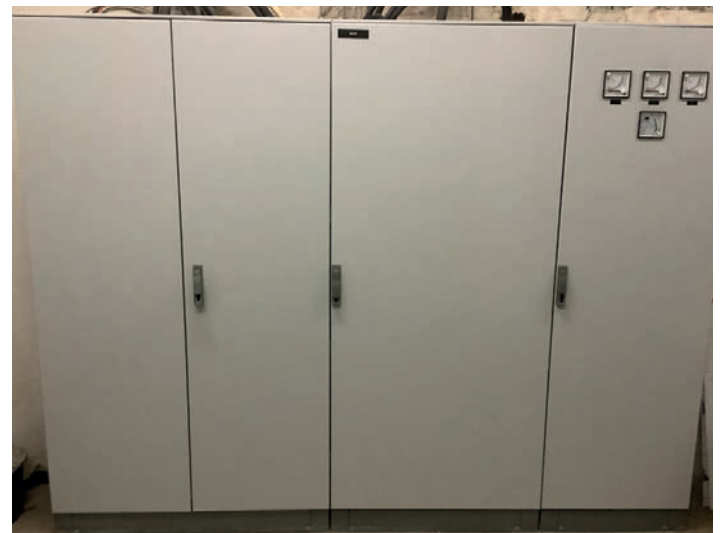
Abbildung 2: Sanierte und modernisierte Niederspannungshauptverteilung
